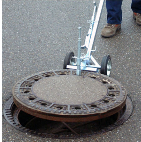
Appareils de canalisation et de regards de visite
